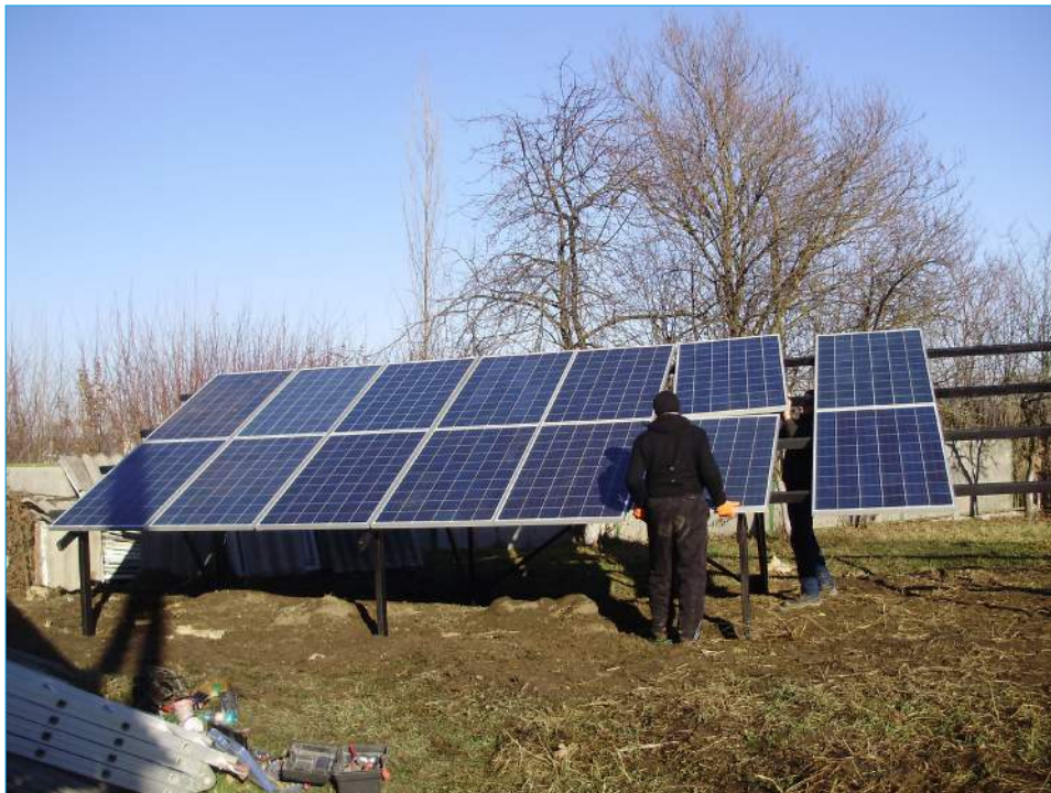
Сонячна електростанція ДНЗ «Сонечко»
