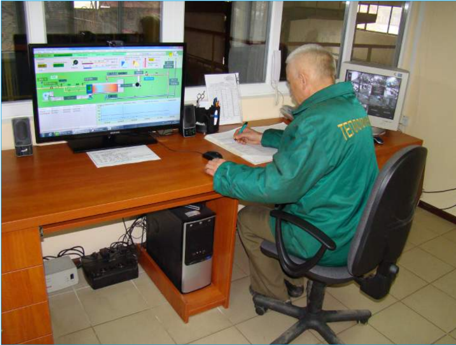
Робоче місце оператора автоматизованої котельні КП «Хмельницьк-теплокомуненерго»
